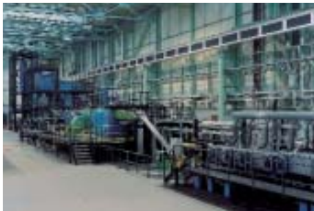
Abb. 1: Technikumshalle des DOC mit Bandversuchsanlage
